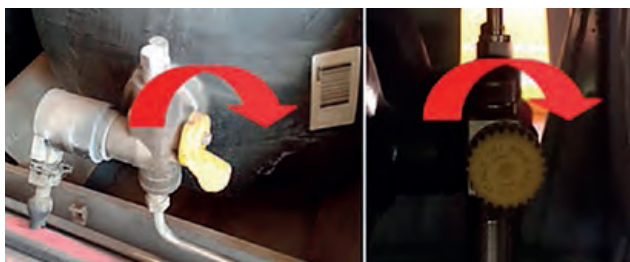
Llaves de cierre manual depósito de GNC
