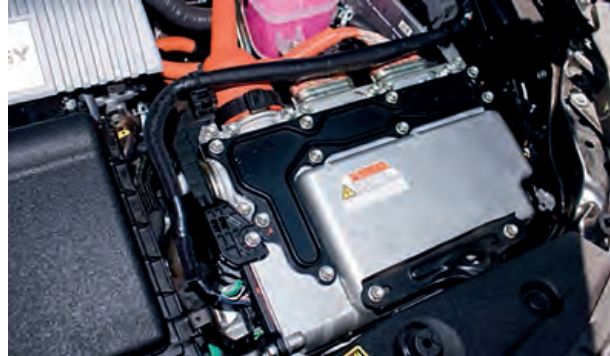
Cableado naranja conectado al inversor/convertidor
